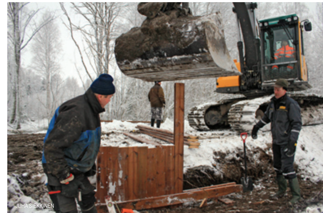
Vedenpinnan korkeuden säätelyä varten rakennettiin kiviverhoiltu pohjakynnys ja siihen lankuista tiivisteseinä irroitettavilla settilankuilla. Seinän lankut painettiin kaivinkoneella yksitellen, jolloin saatiin tiivis rakenne koskemattomaan maahan.
